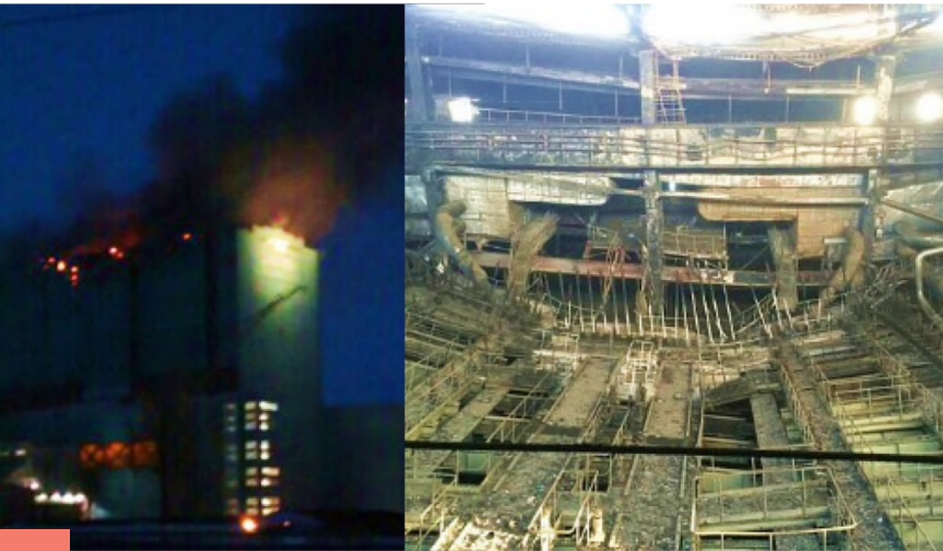
Пожар в котельном отделении Берёзовской ГРЭС
